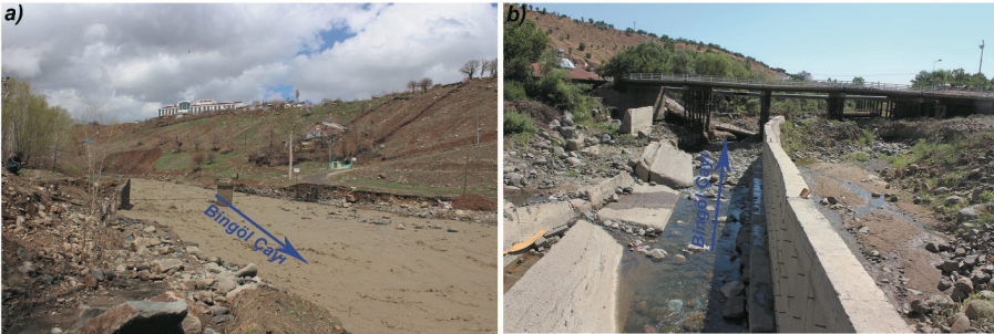
Foto 3. Sel ve taşkınların meydana gelmesinde şiddetli erozyon (a) ve taşkın ıslah çalışmaları ile dere yatağının daraltılmasının (b) etkisi yüksektir
